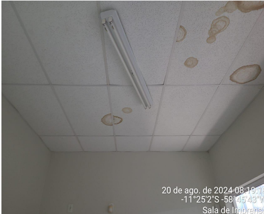
Figura 17 –Sala de Imprensa – Infiltração no Forro de Fibra Mineral Fonte: Pref. Municipal, 2024
