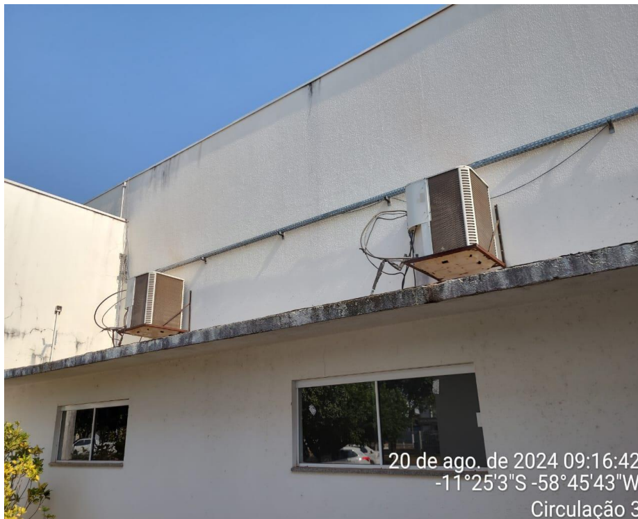
Figura 48 – Circulação 3 – Condensadoras de Ar Fonte: Pref. Municipal, 2024
