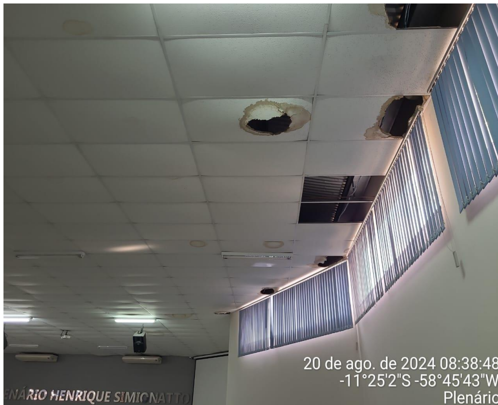
Figura 32 – Plenário – Infiltração da cobertura Fonte: Pref. Municipal, 2024
