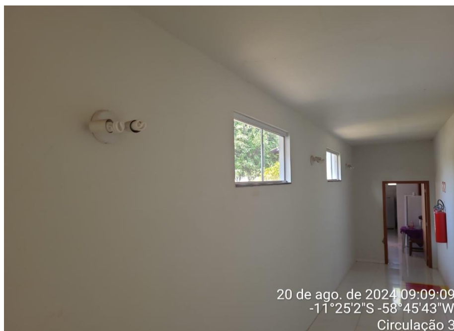
Figura 46 – Circulação 3 – Iluminação em Parede Fonte: Pref. Municipal, 2024
