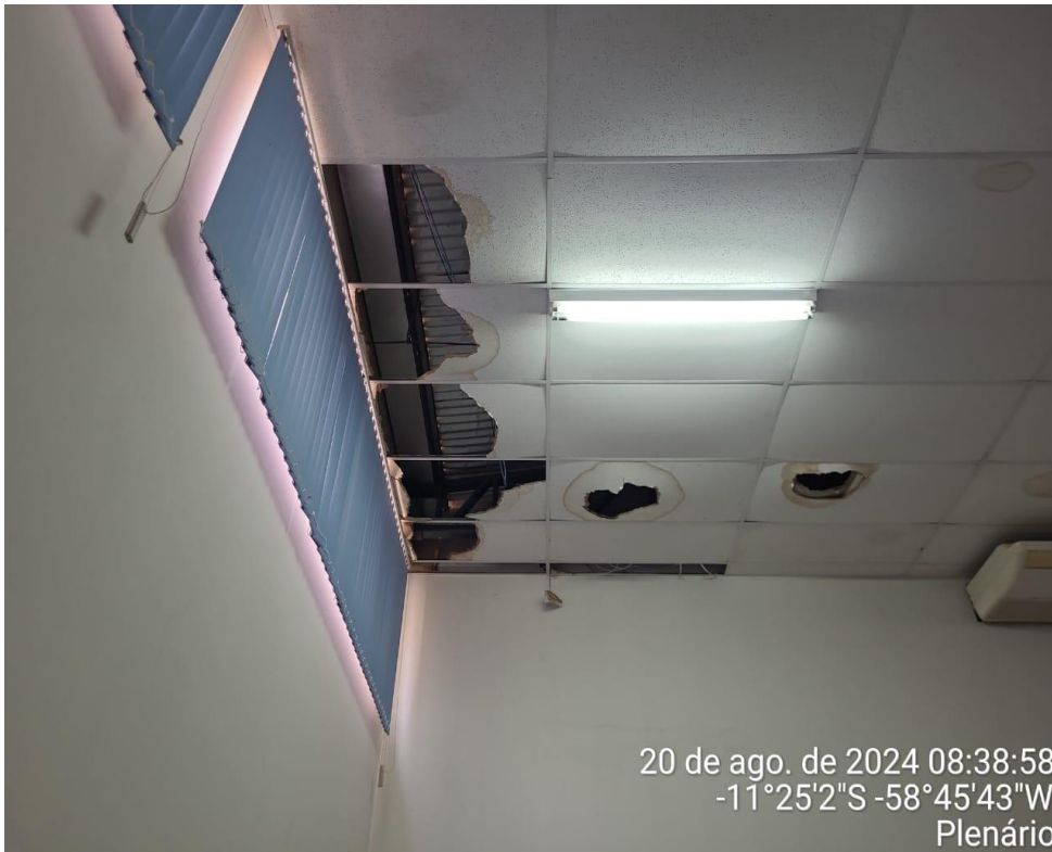
Figura 37 – Plenário – Infiltração da cobertura Fonte: Pref. Municipal, 2024
