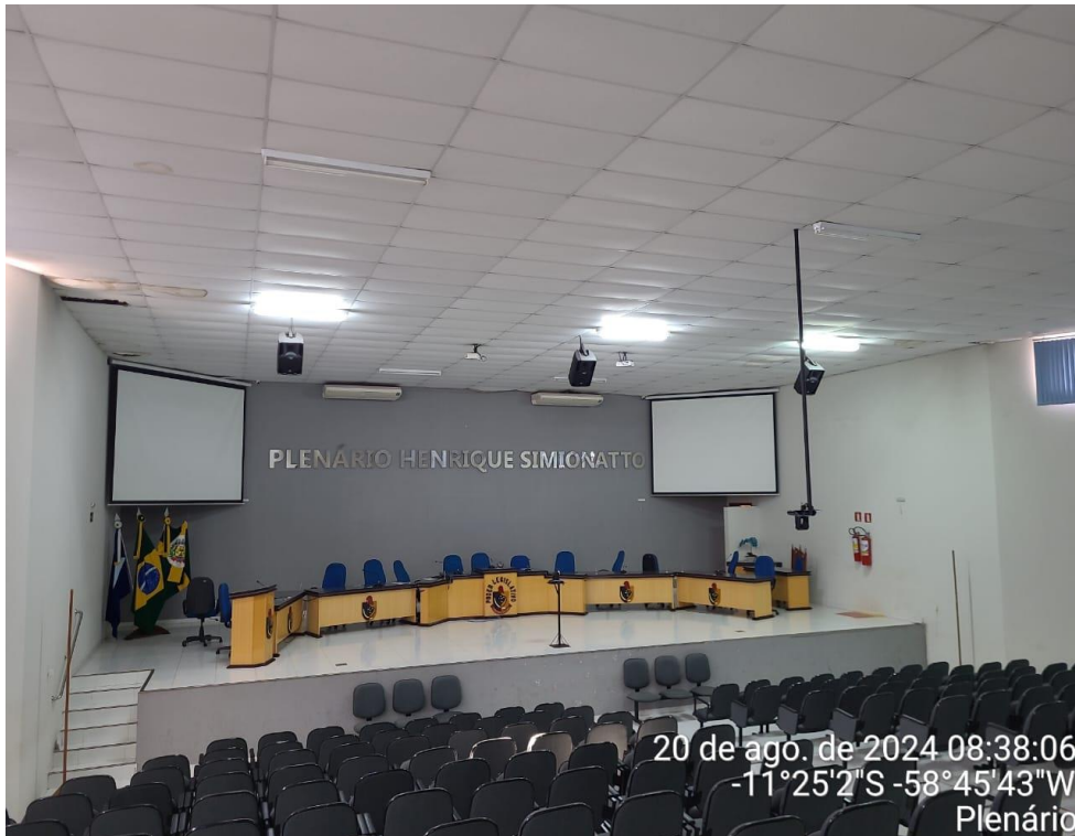
Figura 33 – Plenário – Infiltração da cobertura Fonte: Pref. Municipal, 2024
