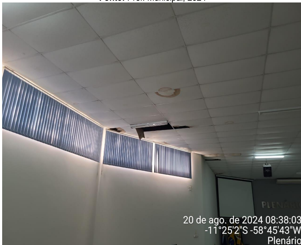
Figura 34 – Plenário – Infiltração da cobertura Fonte: Pref. Municipal, 2024
