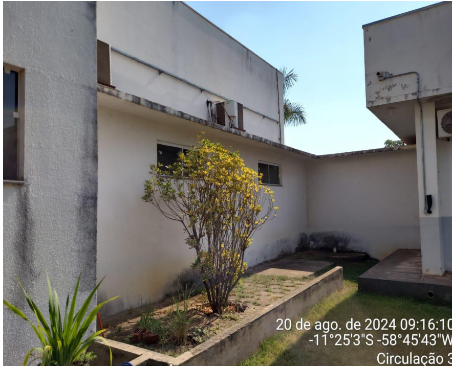
Figura 49 – Circulação 3 – Condensadoras de Ar Fonte: Pref. Municipal, 2024
