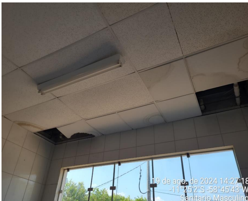
Figura 12 – Forro a ser substituído – Sanitário Fem. (Recepção) Fonte: Pref. Municipal, 2024
