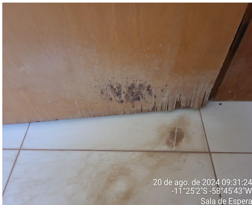
Figura 26 –Sala de Espera – Porta de Madeira deteriorada pela umidade Fonte: Pref. Municipal, 2024
