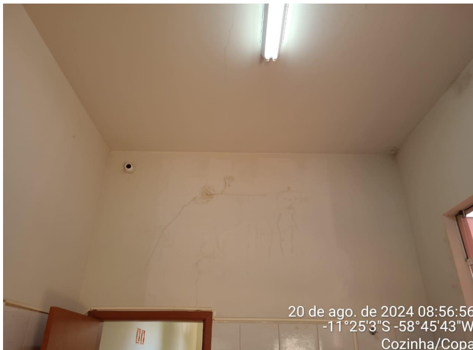
Figura 43 – Fissuras em alvenaria na Cozinha / Copa Fonte: Pref. Municipal, 2024
