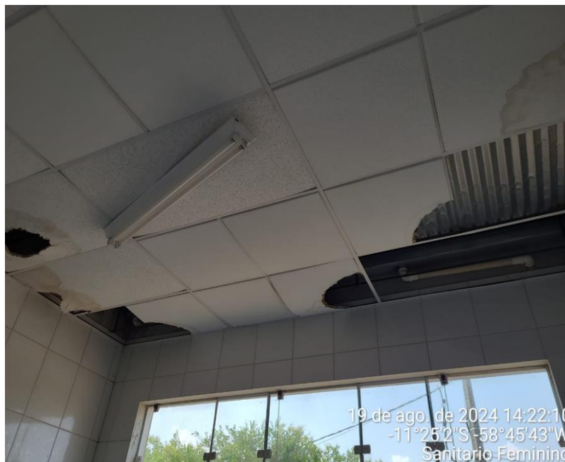
Figura 9 – Forro a ser substituído – Sanitário Fem. (Recepção) Fonte: Pref. Municipal, 2024
