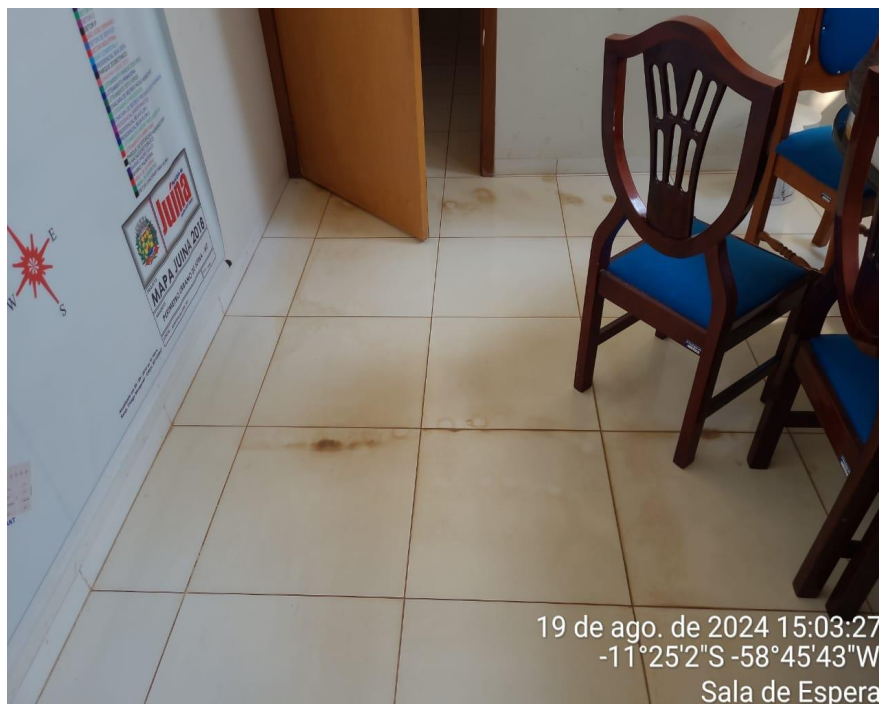
Figura 25 –Sala de Espera – Piso cerâmico manchado Fonte: Pref. Municipal, 2024
