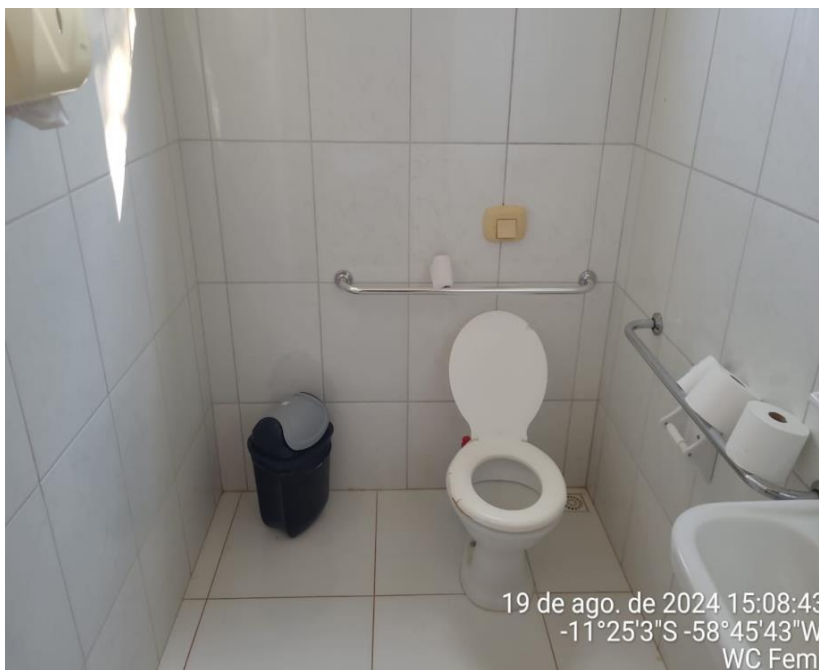
Figura 11 –Instalação da Barra Vertical de Apoio – Sanitário Fem. (Recepção) Fonte: Pref. Municipal, 2024
