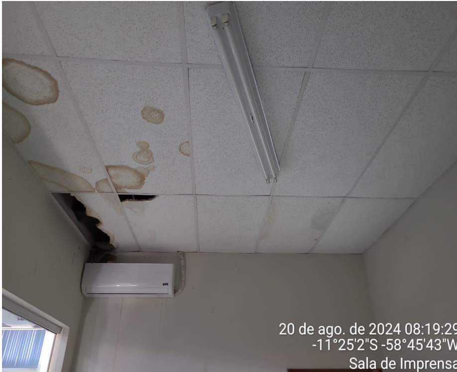
Figura 16 –Sala de Imprensa – Infiltração no Forro de Fibra Mineral Fonte: Pref. Municipal, 2024
