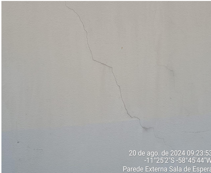
Figura 24 –Sala de Espera – Trincas e Fissuras em Alvenaria Fonte: Pref. Municipal, 2024
