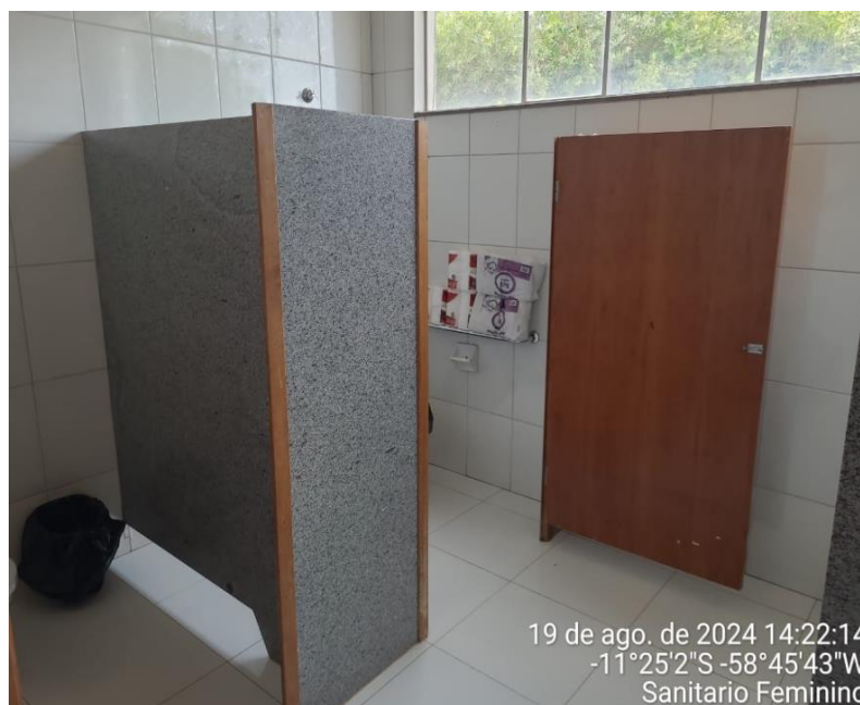
Figura 10 – Porta para Instalação da Barra de Apoio – Sanitário Fem. (Recepção) Fonte: Pref. Municipal, 2024
