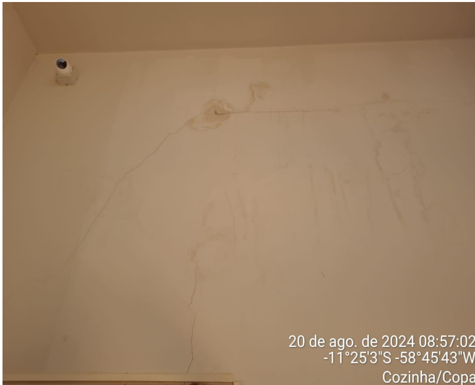
Figura 42 – Fissuras em alvenaria na Cozinha / Copa Fonte: Pref. Municipal, 2024
