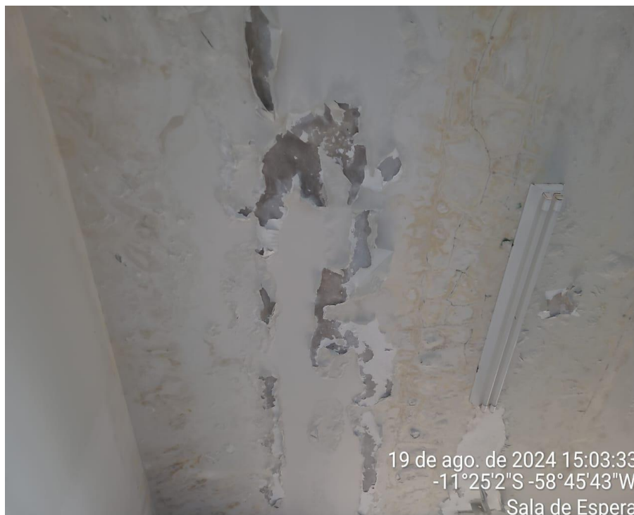
Figura 24 –Sala de Espera – Infiltração em Laje Fonte: Pref. Municipal, 2024
