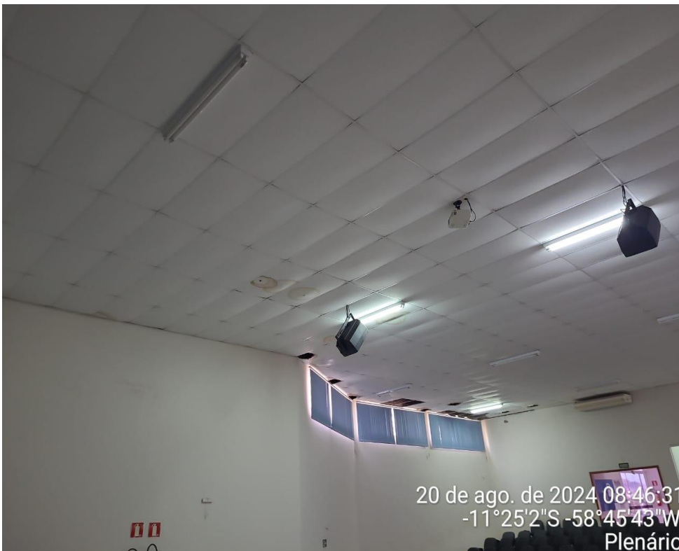
Figura 38 – Plenário – Infiltração da cobertura Fonte: Pref. Municipal, 2024
